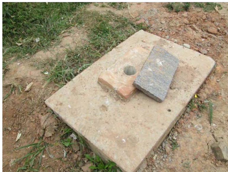
Figura 48: Reservatório de churume enterrado.
